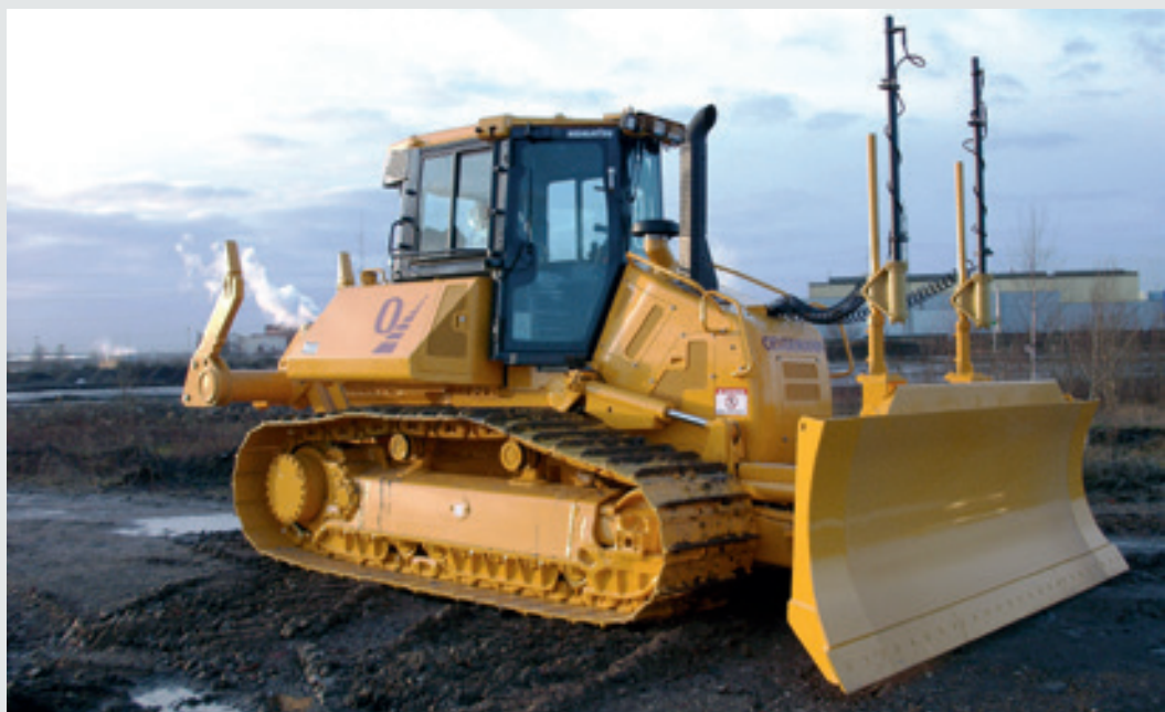
Planierdraupe Komatsu D 61 PX-23 mit Maschinensteuerung im Einsatz auf der Baustelle Westfalenhütte in Dortmund
